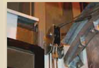
2 câbles type aviation 7 torons par côté
